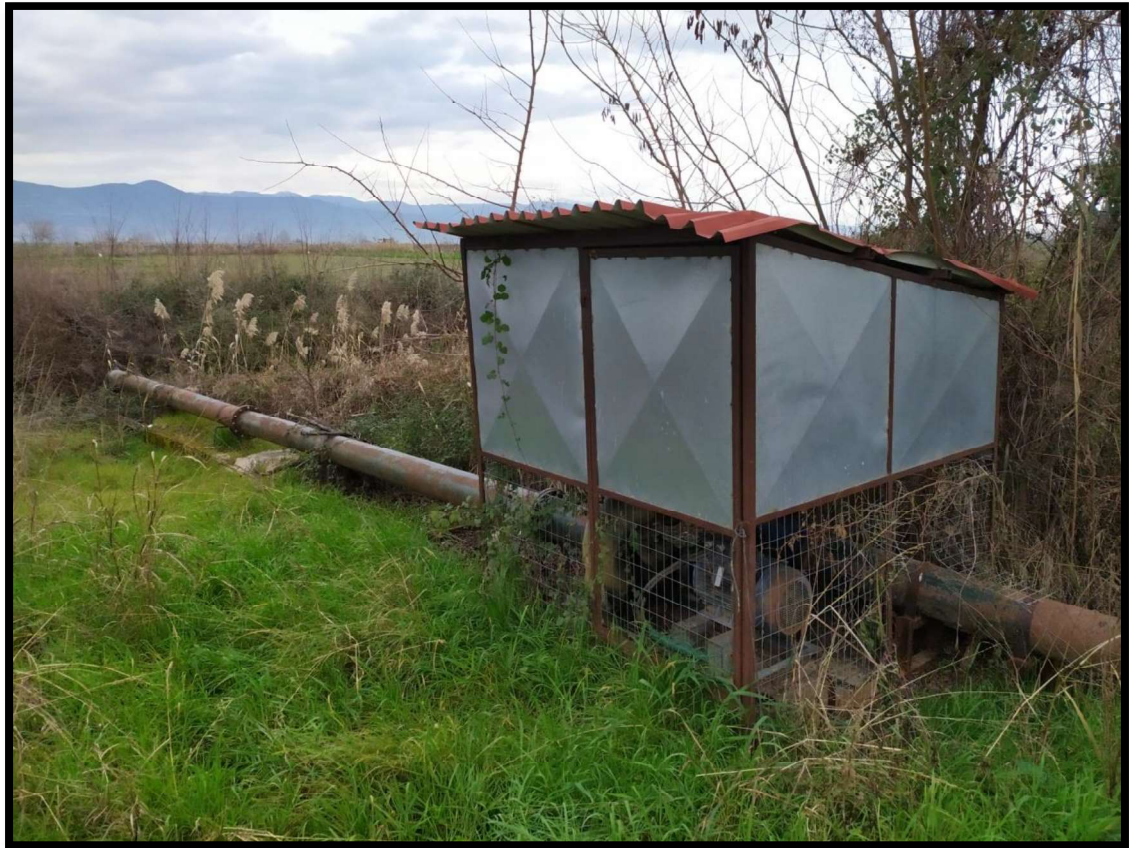
Φωτογραφία 1: Υφιστάμενο αντλιοστάσιο στο Ποταμό Σπερχειό
